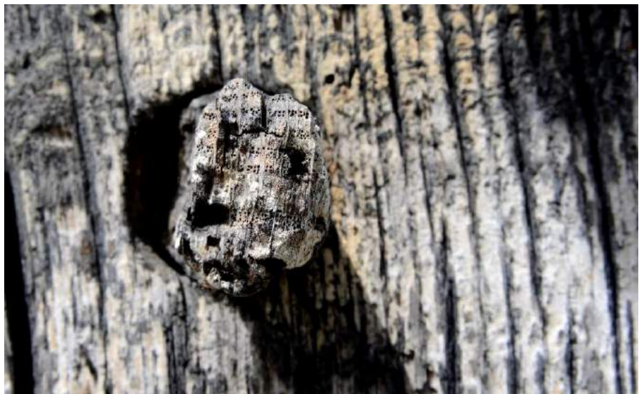
Figur 96: Nagle i østlængens sydgavl ved en af gavlknægtene. Egens ringporede vedstruktur fremtræder i den vejrbitte nagle.
