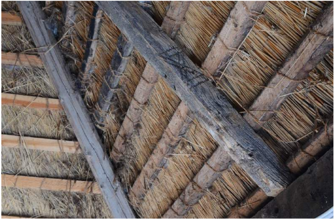
Figur 56: Husbrand, genanvendt som valmspær i stuehusets vestgavl. Bemærk de to naglehuller ved andreaskors.
