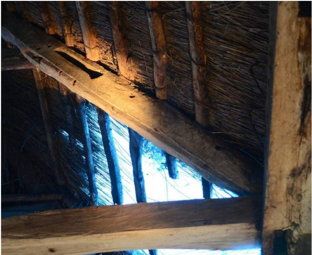
Figur 83: Vestlængens østlige tagflade. Genanvendt gavlspær. Øverst tv. ses det fjernede gavlhanebånds skrå taphul. Det store taphul ved siden af har båret en skrå knægtkonsol til støtte for det udkragede hanebånd. De to afborede naglehuller er spor efter knægtkonsollens fornagling. På spærets underflade ses noten der slutter ved hanebåndstaphullet, fordi overgavlen har udkræning.
