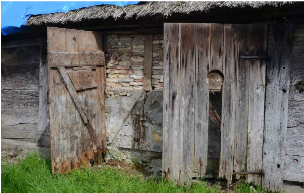
Figur 86: Vestlængen har i vestfacaden en dobbeltfløjet, båndhængslet port fra sent 1800-årene. Billedet viser den indre tilmuring i forbindelse med tærskeloens indretning til hestestald.
