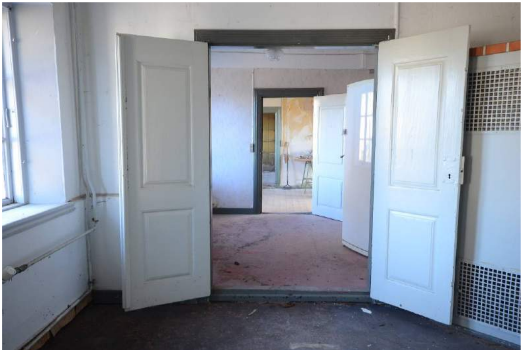
Figur 46: Stuehusets nordlige rum set mod øst fra storstuen gennem forstuen, mellemstuen og ud til køkkenet.
