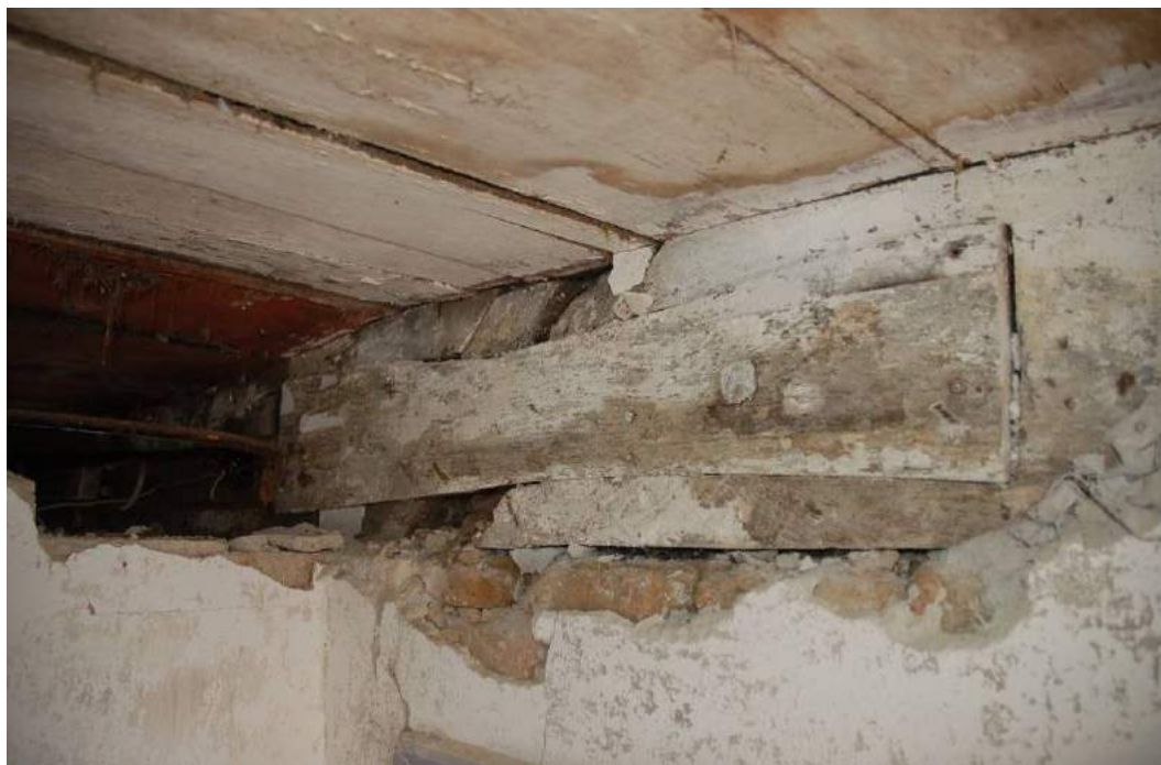
Figur 42: Bindbjælke i bryggerset. Bjælken har et brud og er repareret med en indfældet laske.
