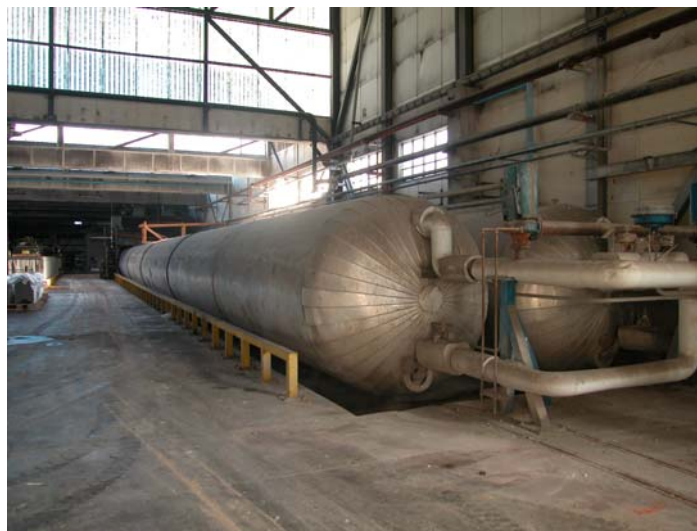
Figur 49. Autoklaveanlæg i den store shed-tagsbygning. 2004. Foto Morten Pedersen
