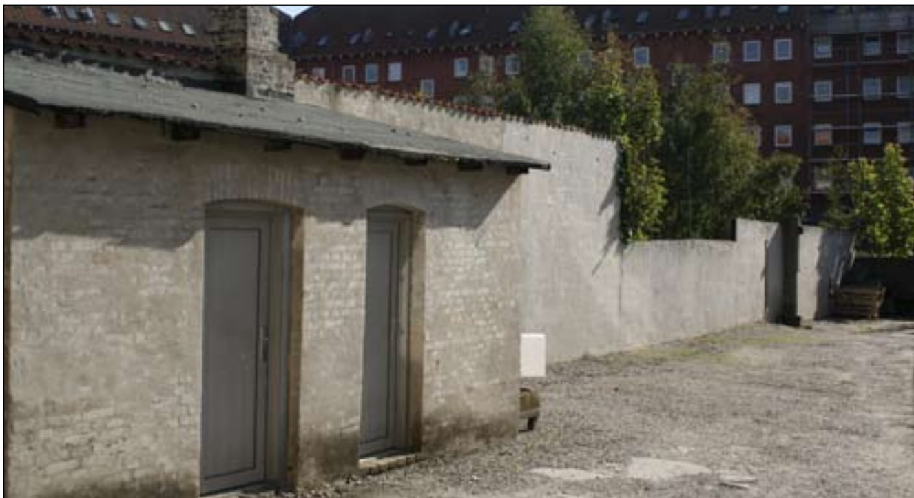
Nedslidte bagbygninger i Vangsminde Karreen
